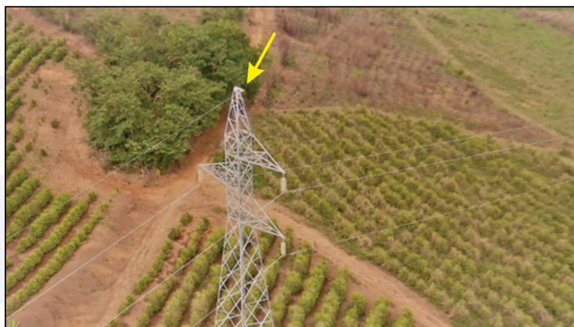
Figura 2 - Posição do cabo para-raios à direita da Torre 8.
